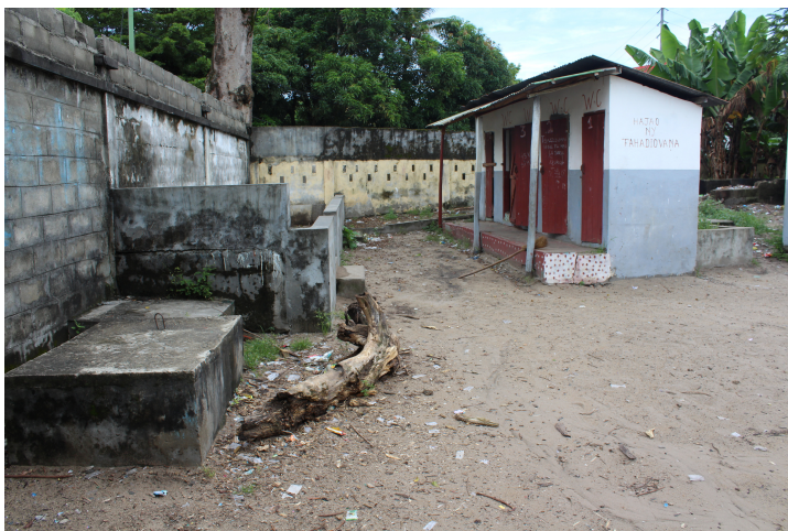
Les Latrines à rénover
